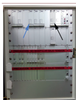
Moderno sistema integrado de comunicación ferroviaria. El concepto básico del comunicación mediante escalonados (azul) y con el Punto de Mando (negro) sigue siendo el mismo
